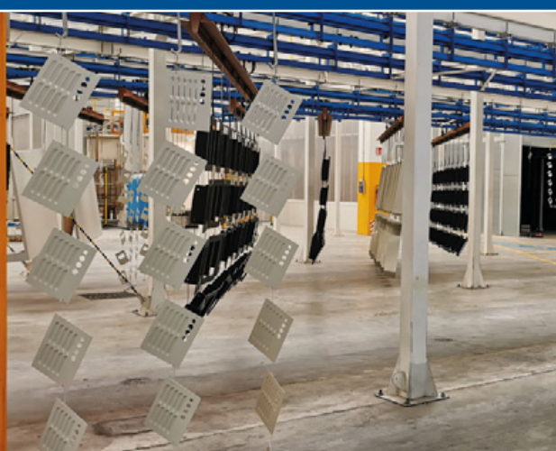
Scorcio dell'impianto di verniciatura, zona di scarico con forno di cottura e cabine sullo sfondo
